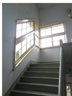
圖 12. 舊有樓梯窗戶為平行四邊形
