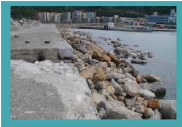
2002年辛樂克颱風過後，堤防破壞情形。
