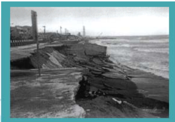
1996年賀伯颱風過後，茄荳海濱休閒平台破壞情形。
